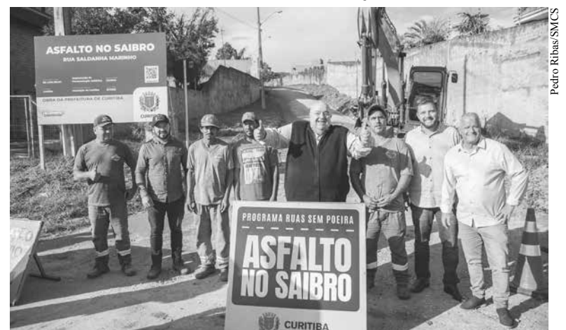
Prefeito Rafael Greca vistoria as obras de pavimentação sobre saibro, na Rua Saldanha Marinho, no Campina do Siqueira
